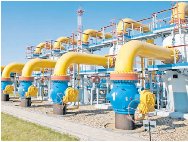
Компрессорная станция «Торжокская»
