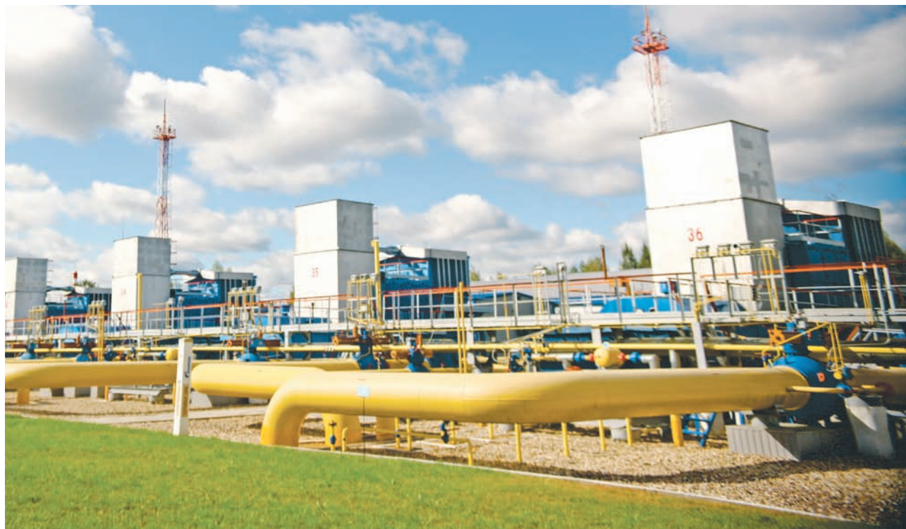
Компрессорная станция «БИС» филиала ООО «Газпром трансгаз Санкт-Петербург» – Торжокское линейное производственное управление магистральных газопроводов
