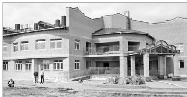
Детский сад в Чуприяновке был в числе «недостроя». Работы на нем возобновились по поручению главы региона Игоря Рудени
