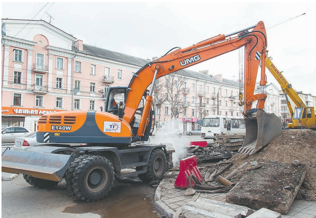
За 2016 год в Твери будет капитально отремонтировано более 20 километров теплотрасс на 87 участках теплосетей. Объем финансирования работ составит 170 миллионов рублей
