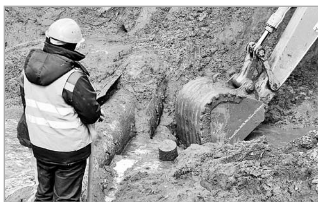
По программе реконструкции в Твери будет заменено порядка двух километров магистральных сетей, 15 километров распределительных тепловых сетей
