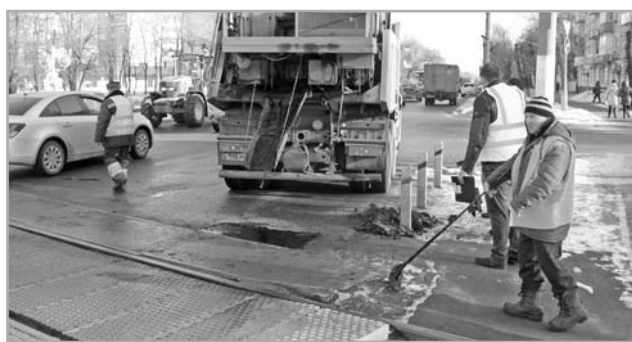
Работы ведутся с применением литого асфальтобетона, позволяющего производить ямочный ремонт практически при любых погодных условиях
