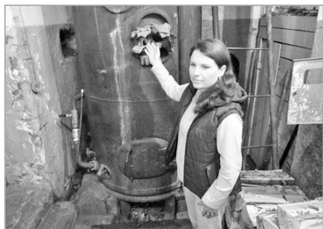
В Осташковской бане необходимо заменить котел, считает Ольга Рожковская
