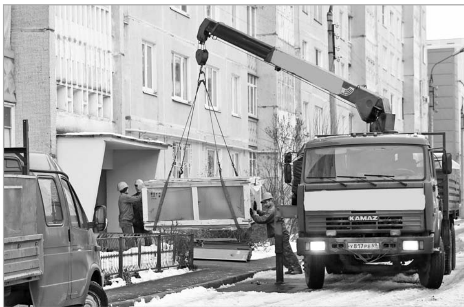
В региональную программу по капремонту включено 11195 многоквартирных домов
