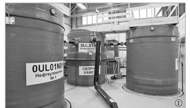
Комплекс очистных сооружений не имеет аналогов в отрасли по уровню автоматизации процессов и качеству очистки сточных вод
