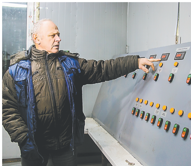
Современное оборудование, пульт управления сушилкой
