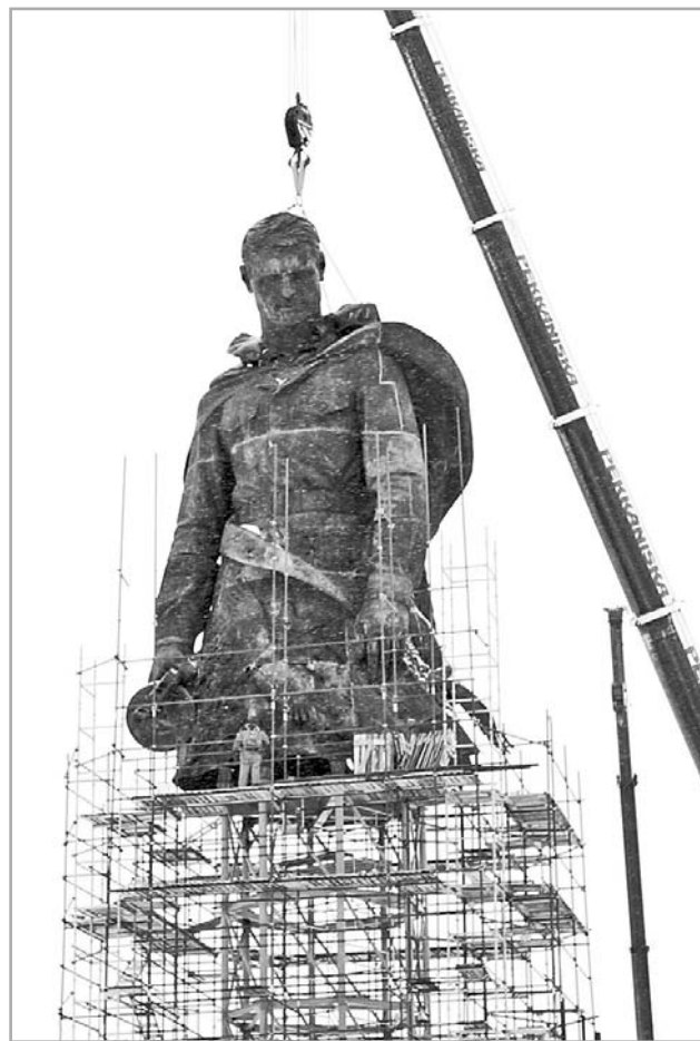
Финальный этап монтажа центральной части Ржевского мемориала завершился установкой верхнего элемента – головы солдата.
