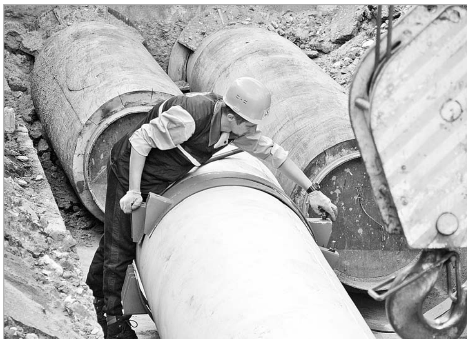
В ходе испытаний с начала ремонтного сезона выявлено 224 повреждения на магистральных сетях и 60 – на разводящих. Большая часть из них уже устранена
