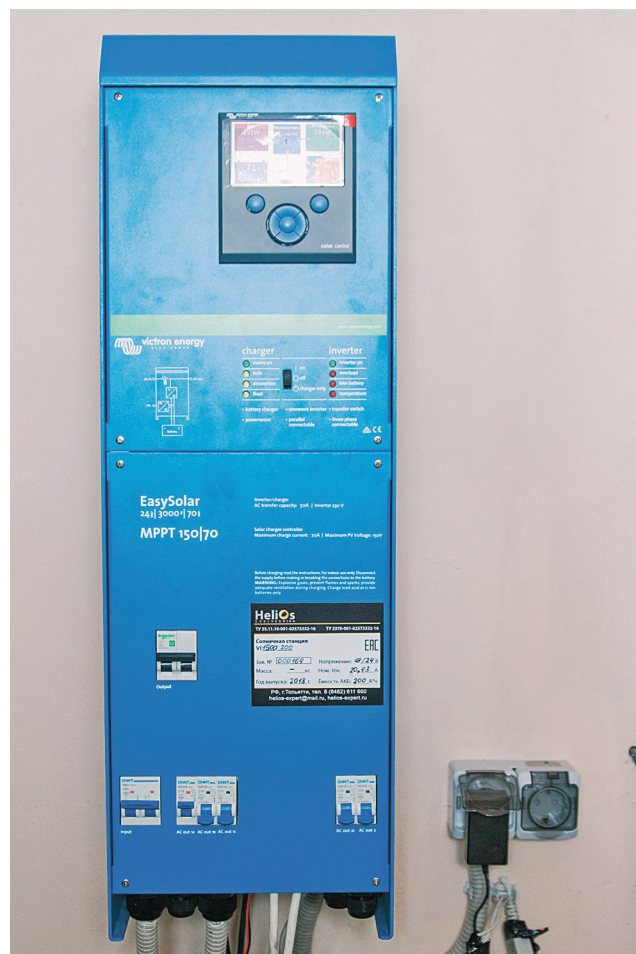
Инвертор преобразует энергию, поступающую от солнечной батареи
