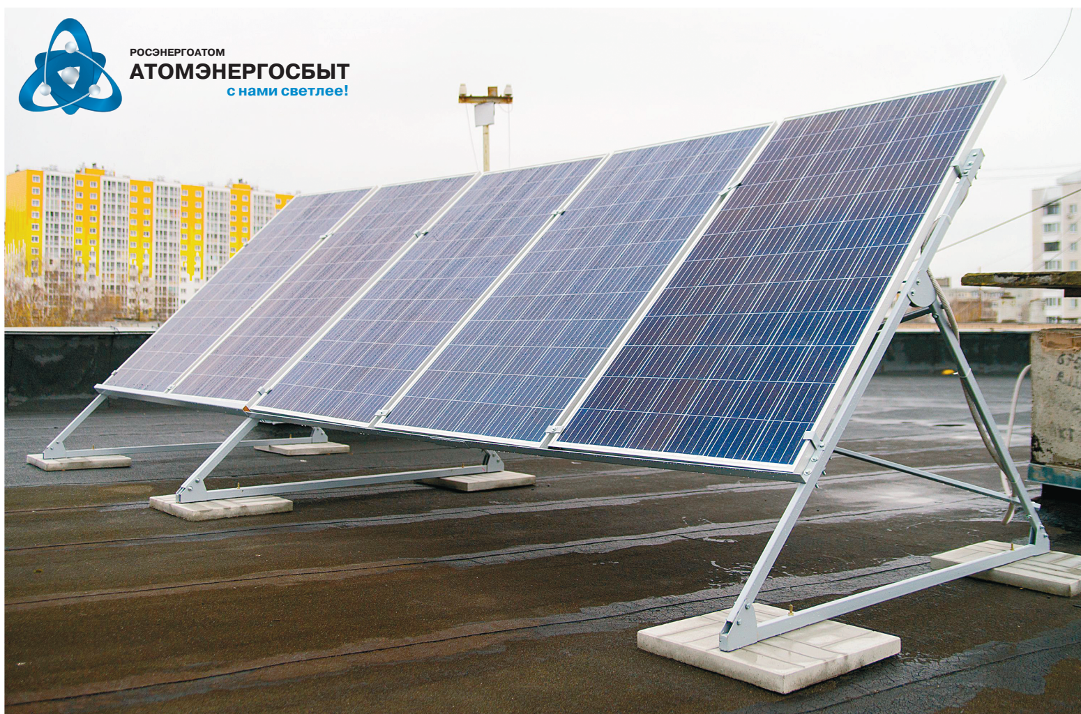
Солнечная панель на крыше дома – дополнительный источник электроснабжения, за счет которого можно восполнять затраты на энергоносители
