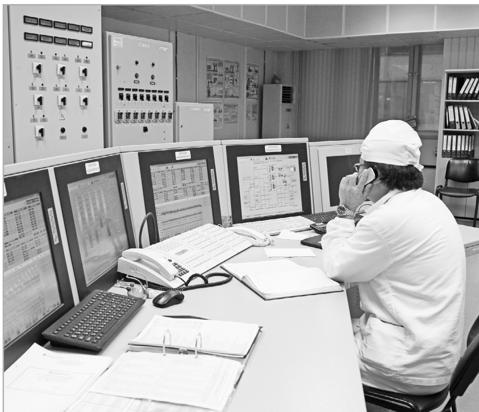
Щит радиационного контроля энергоблоков № 3 и № 4 Калининской АЭС. Такой же будет АСРК на энергоблоках № 1 и № 2 КАЭС
