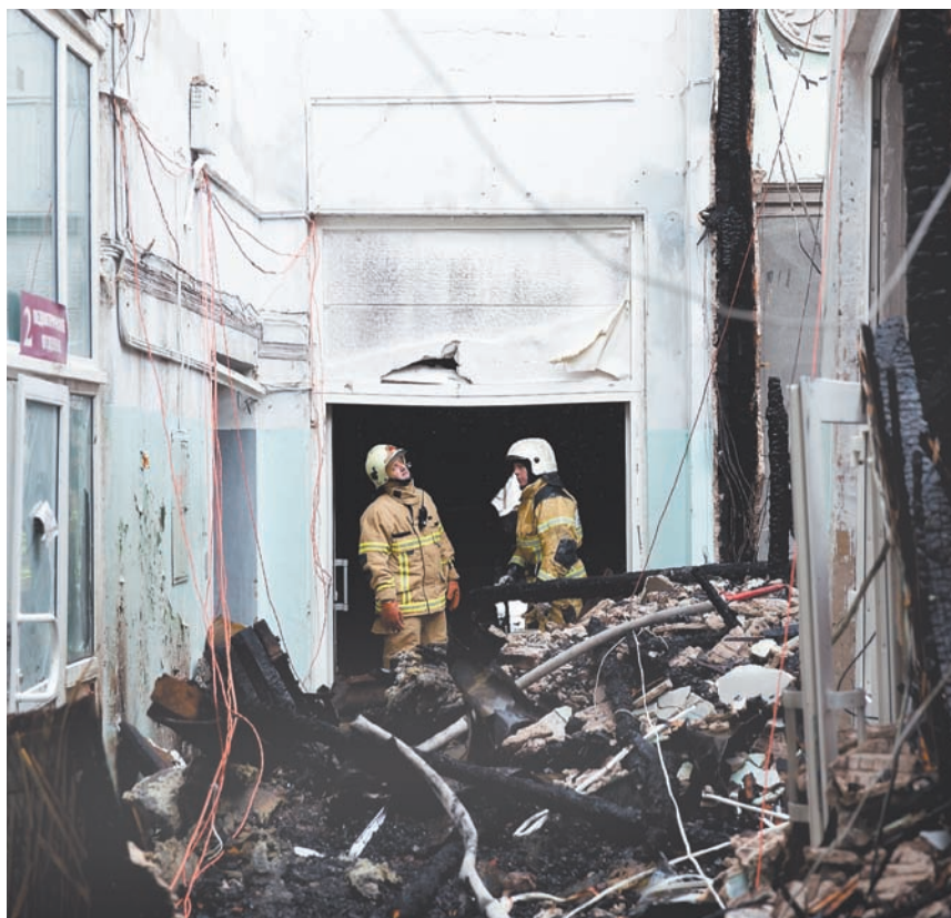
Огнеборцы осматривают повреждения здания Детской областной больницы после страшного пожара
