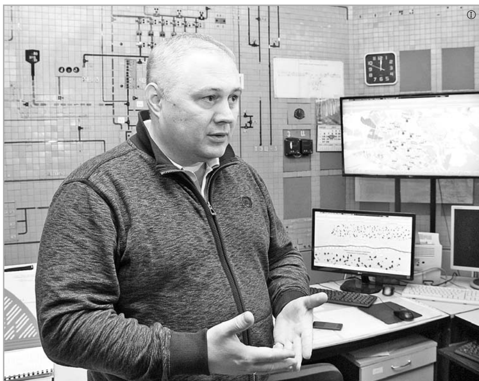
Диспетчеризация и автоматизация объектов «Тверь Водоканала» позволила значительно улучшить качество предоставления услуг жителям города
